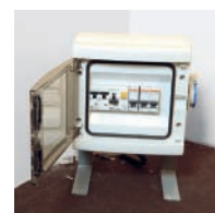
Cuadro eléctrico con enchufe
