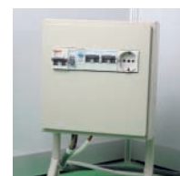
Cuadro eléctrico con enchufe
