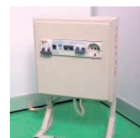
Cuadro eléctrico con enchufe
