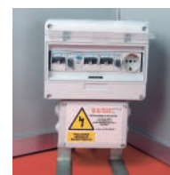
Cuadro eléctrico con enchufe
