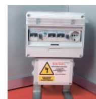
Cuadro eléctrico con enchufe
